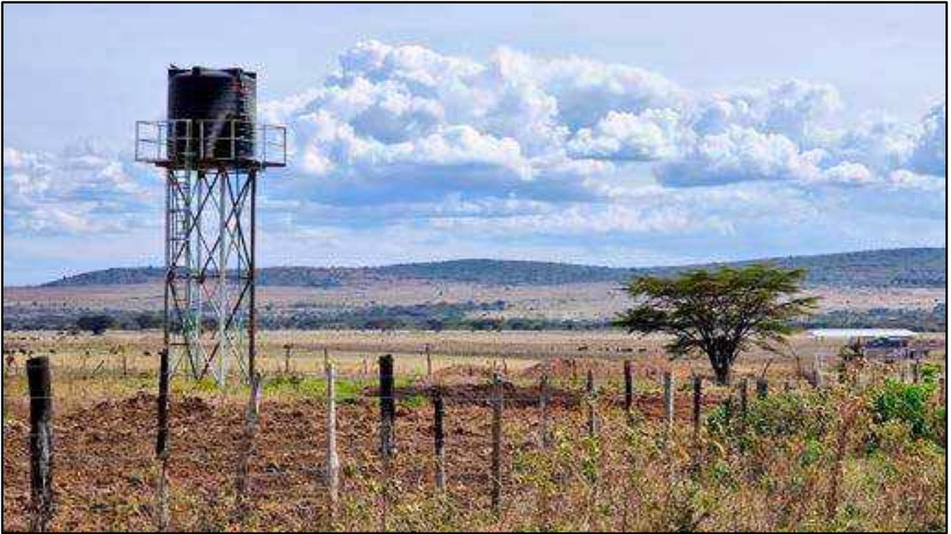
De watertank loopt over vanwege technisch defect. Goed beheer moet worden geleerd.
