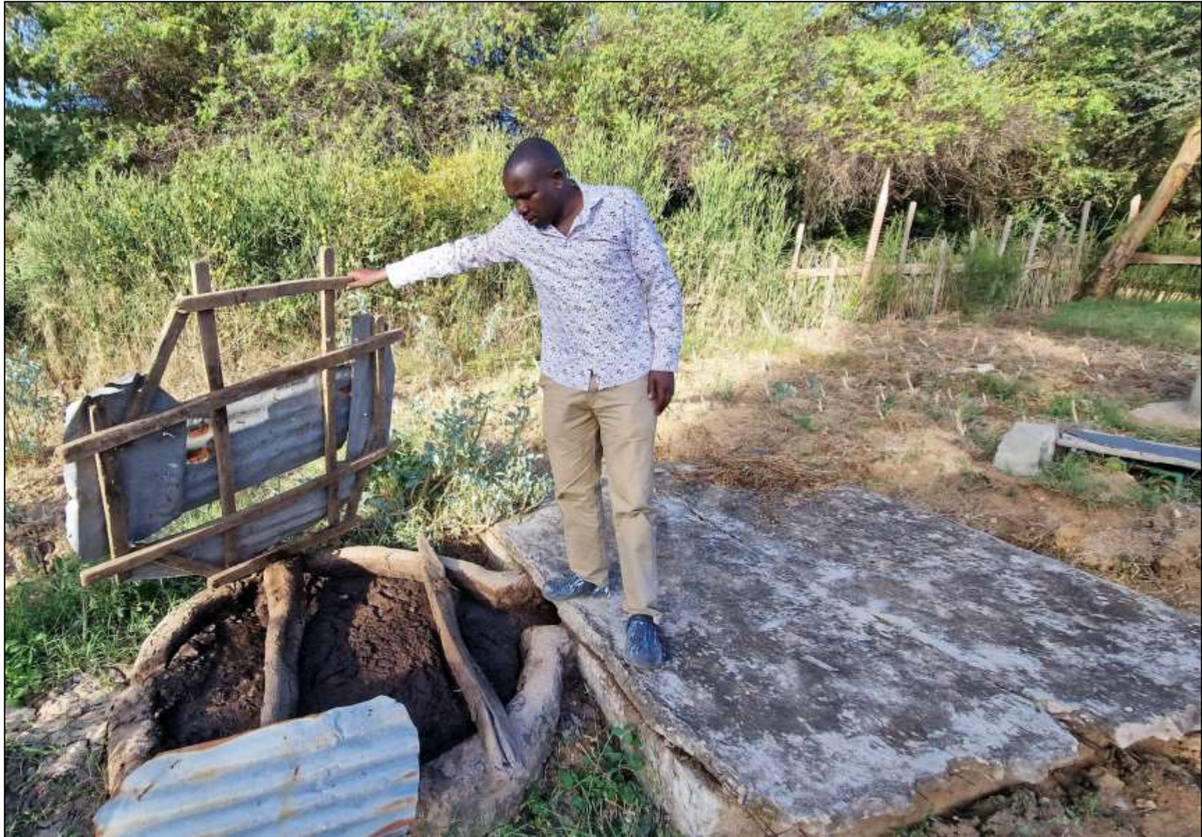
De biogas-installatie wordt geïnspecteerd en gedemonstreerd.
